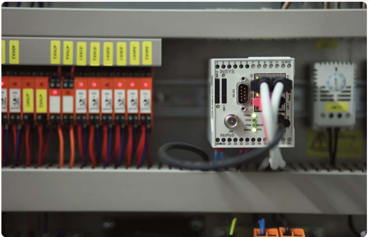
Bild 1: Mobilfunkrouter MoRoS HSPA kann redundante Datenverbindungen über Mobilfunk (3G, 2G) und über DSL-Modem aufbauen.
